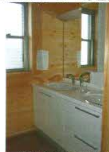
2ボウルを設置した洗面・・・広いです。
