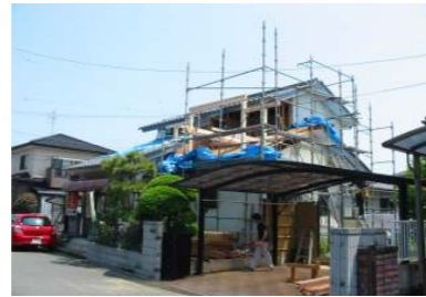
増築部建て方
